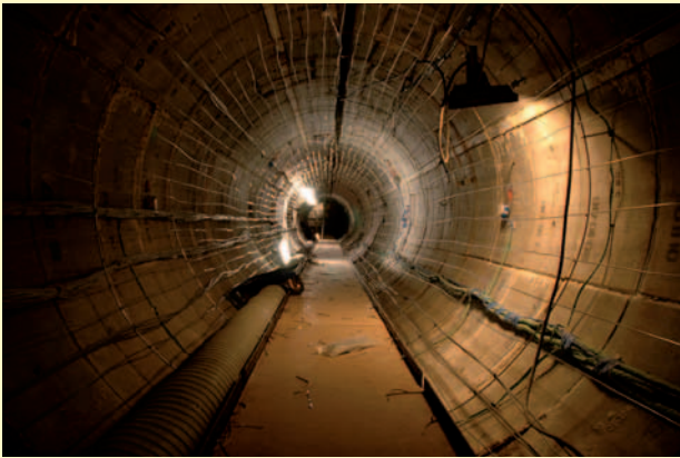
Het verwarmingssysteem is tegen de wand van de PRACLAY-galerij bevestigd.
