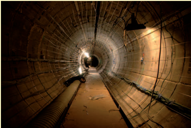
Le système de chauffage est fixé contre la paroi de la galerie PRACLAY.
